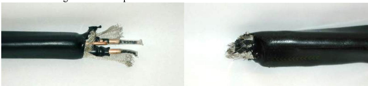
Strgani konci kabla EXCEL in AXCES™. Poškodba je lokalna.
